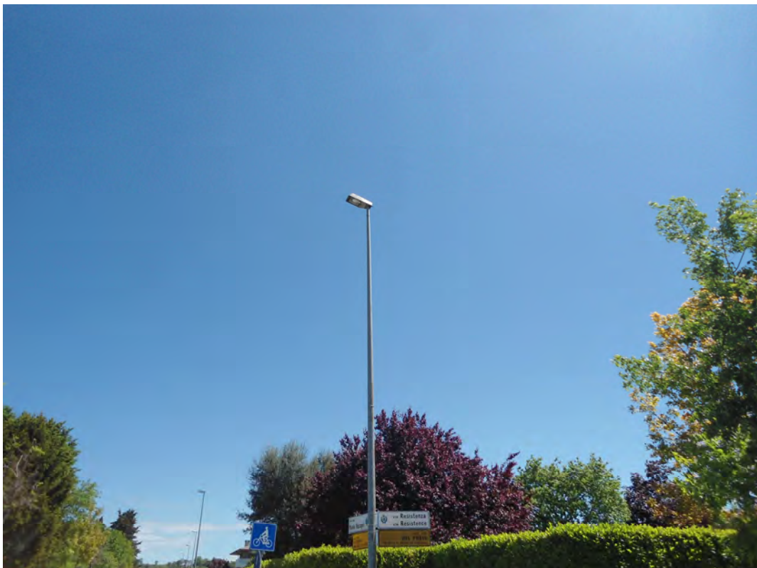
Via Racagni armatura non cut-off (da sostituire)
