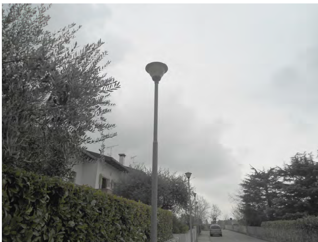
Via Matteotti armatura di arredo urbano (senza frangi luce, da sostituire)
